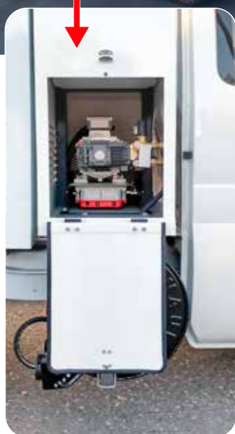
Armario protector del motor, bomba y deposito de agua.
